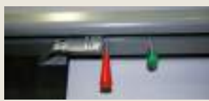
Débrayage manuel du moteur à l'intérieur du garage en cas de panne de courant
